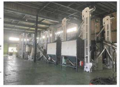
静電分離工程
